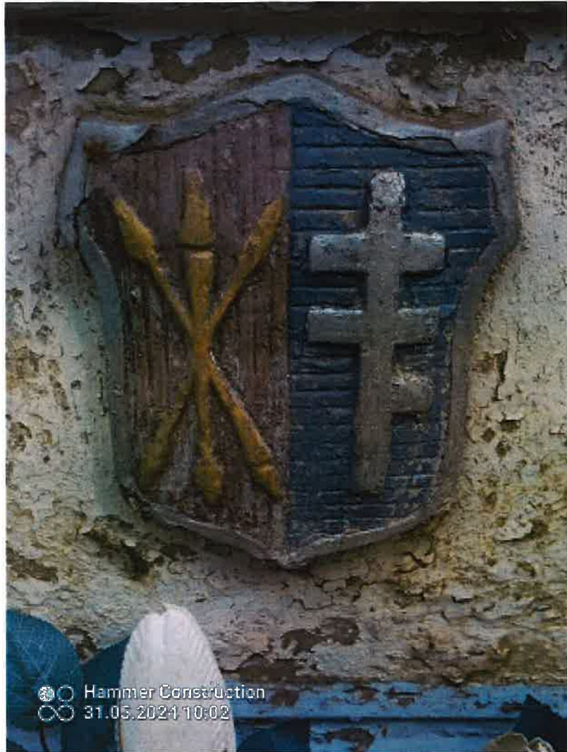
Tarcza herbowa – widoczne zniszczenia warstw malarskich i kamienia
