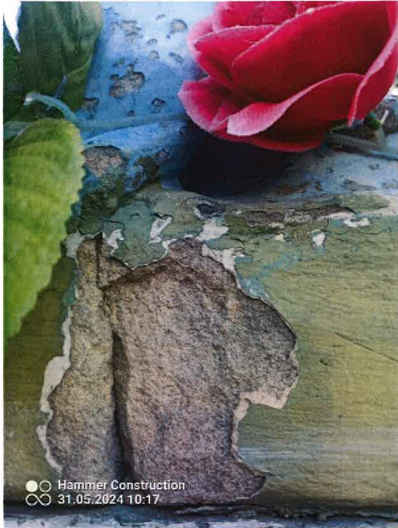
Pęknięcia i uszkodzenia kamienia w postumenciku rzeźby Matki Boskiej
