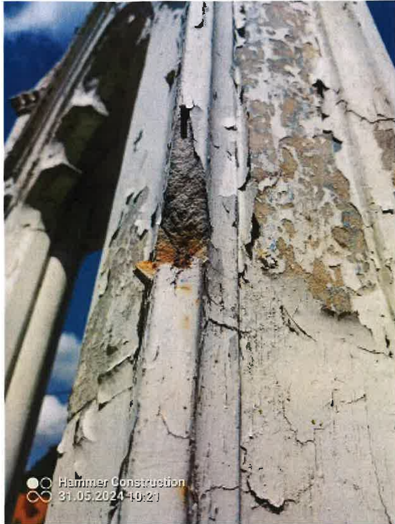
Uszkodzenia części arkadowej spowodowane przez rdzę i łuszczące się warstwy polichromii.
