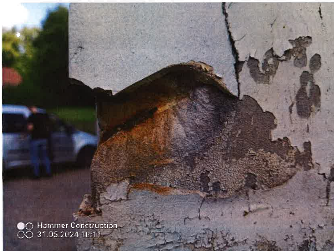
Widoczny ubytek kamienia spowodowany rozsadzeniem go przez korodującą kotwę
