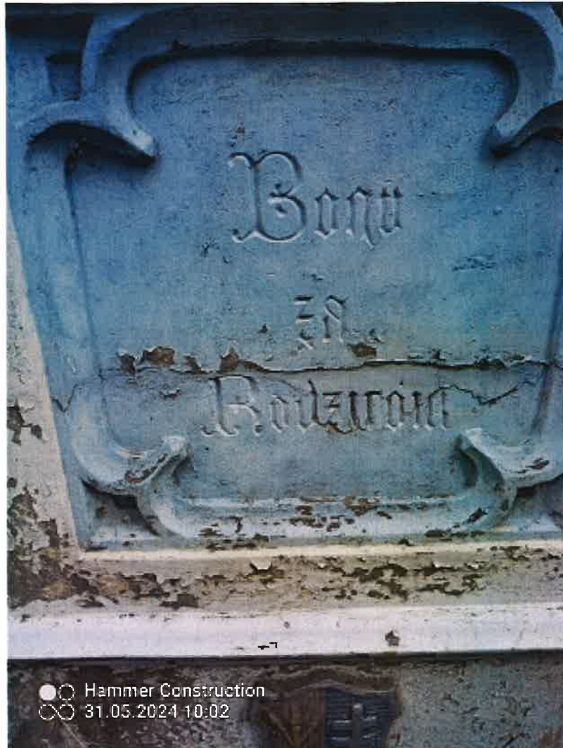
Płycina cokołu- frontowa- pęknięcie kamienia
