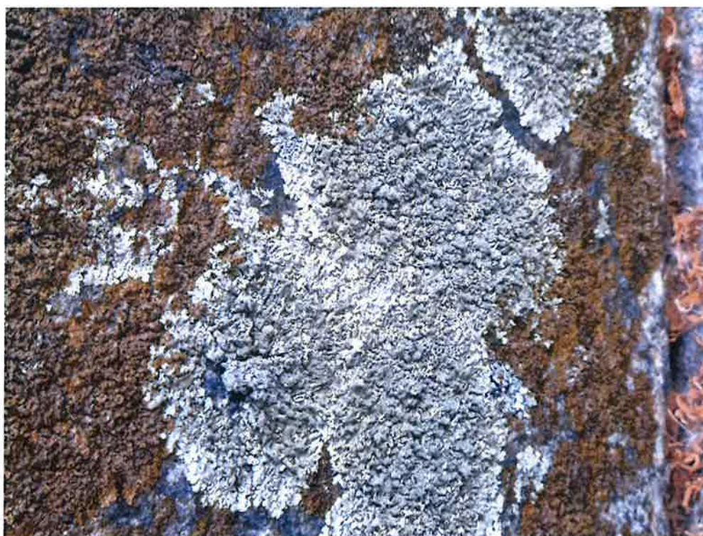
FOT. 7, FOT. 8 Różne formy zniszczeń kamienia.
