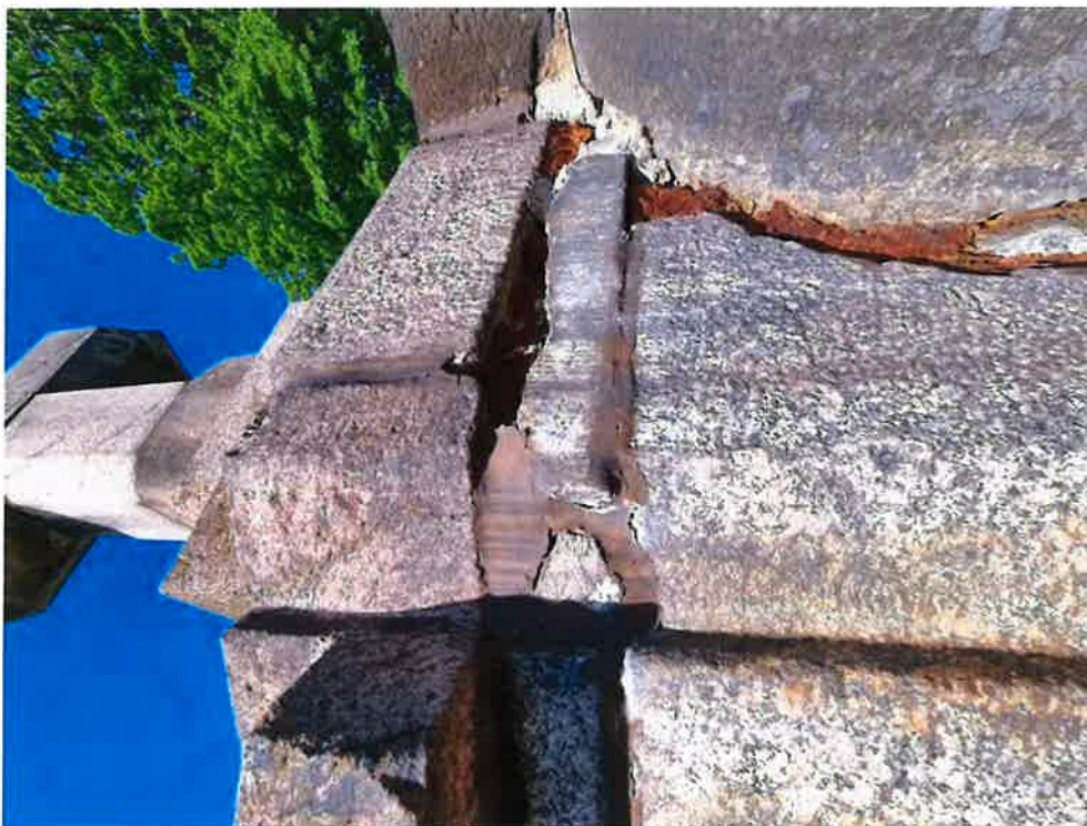
FOT. 11 Ubytek w granicie w tylnej części grobowca; widoczne wtórne spoinowanie.
