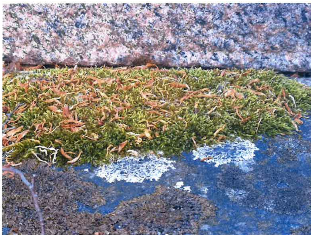
FOT. 9, FOT. 10 Różne formy zniszczeń kamienia.
