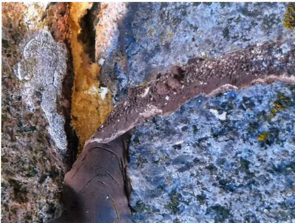
FOT. 6 Fugi pomiędzy ciosami granitu wtórne wypełnione pianką izolacyjną i fugą silikonową.
