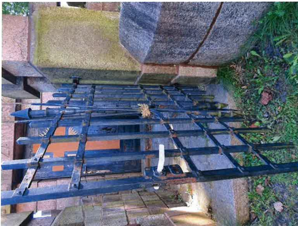
FOT. 13 Stan zachowania metalowej furtki.
