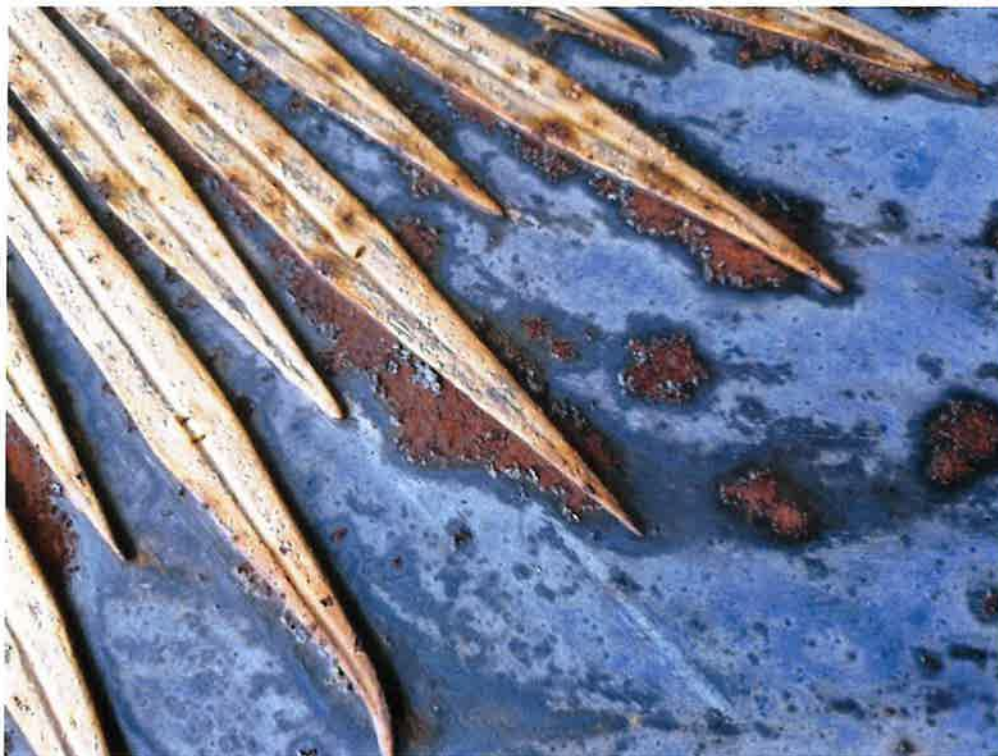
FOT. 15, FOT. 16 Stan zachowania metalowych drzwi (wybrane fragmenty).
