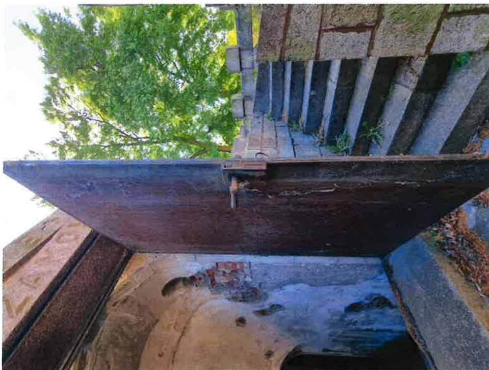
FOT. 17 Stan zachowania metalowych drzwi (wybrane fragmenty).
