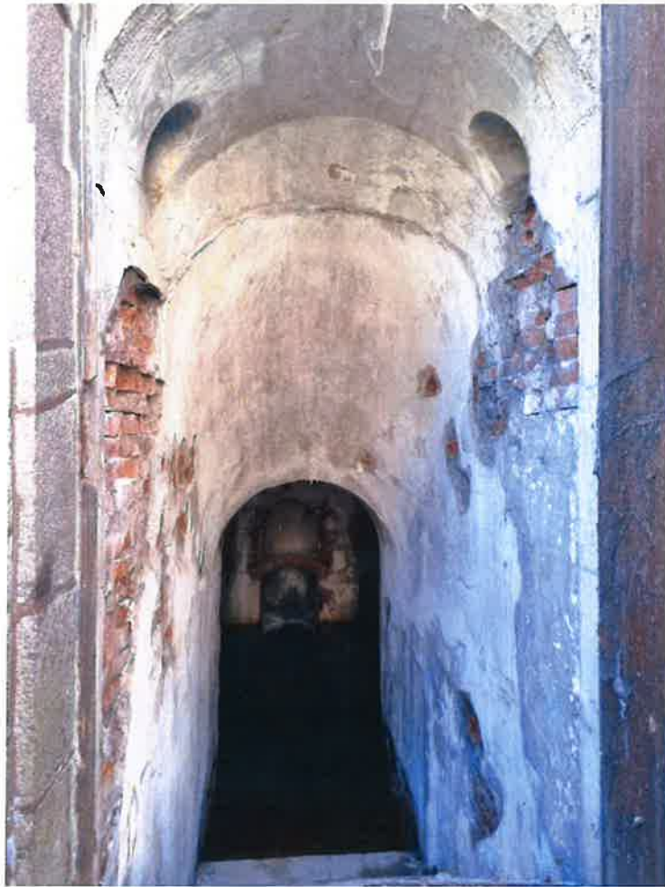
FOT. 19 Stan zachowania ścian w zejściu do krypty grobowej.
